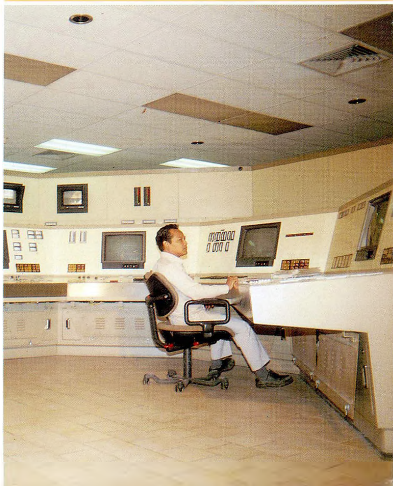
Bilik kawalan unit di Stesen Janaelektrik Pelabuhan Klang Fasa I.
